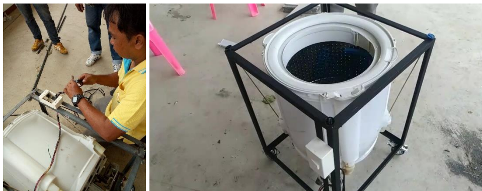
ภาพการติดตั้งระบบไฟฟ้าเครื่องปั่นแห้งดอกดาวเรือง
